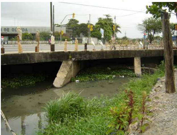
Deslocamento de apoio da ponte sobre o canal da malária
