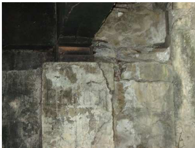
Esmagamento de um dos apoios extremos da viga principal
