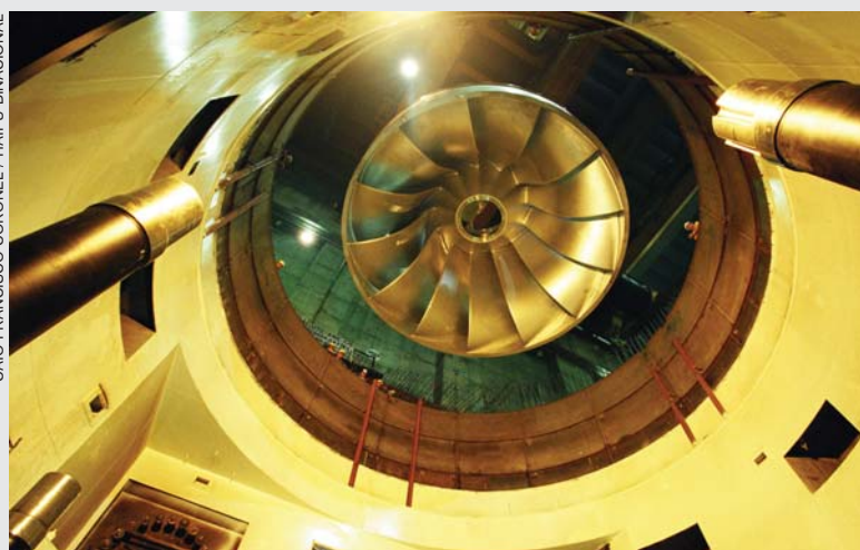
Energia: montagem de turbina, na hidrelétrica de Itaipu, no rio Paraná
